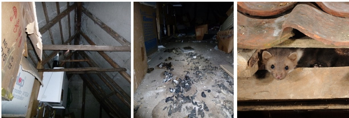
Voorkomen van steenmarter op een zolder. Boven de afvoer van de CV ketel is een opening waar de steenmarter doorheen kan. Op de zolder zijn diverse uitwerpselen gevonden van steenmarter (foto's: Haico van der Burgt; steenmarter onder dakpannen; bron: www.onzenatuur.be ).
