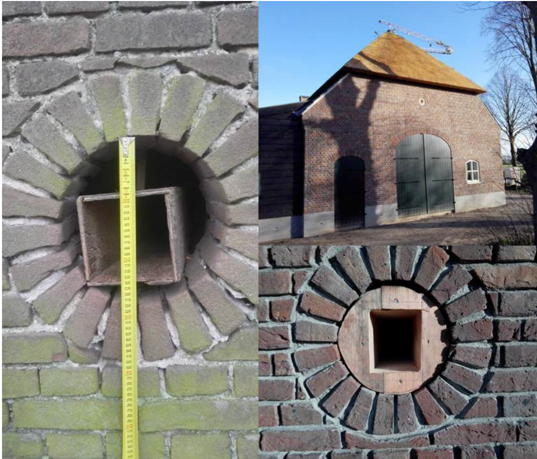
Bovenstaand een oude ingang van een uil in een gebouw. Achter de bestaande opening wordt een kast geplaatst en de ingang van de kast wordt in de oorspronkelijk ingang geplaatst. De gang dient een binnenmaat te hebben van minimaal 15 bij 15 cm. De overgebleven ruimte is afgedicht (bron: onbekend (internet)).
