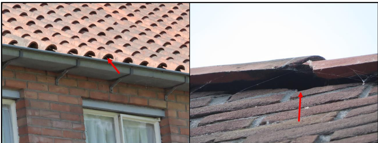
Figuur 2.6. Ruimtes onder de gegolfde dak- en nokpannen van de twee te slopen woningen zijn geschikt bevonden als verblijfplaatsen van vleermuizen.
