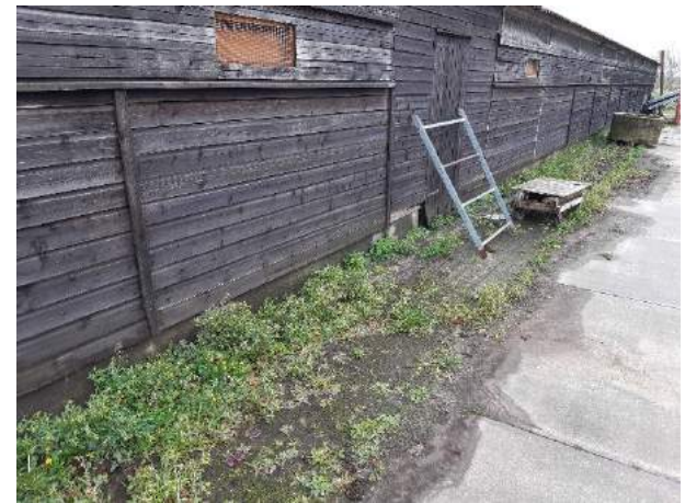
Klinkerverharding ter plekke van druppelzone
