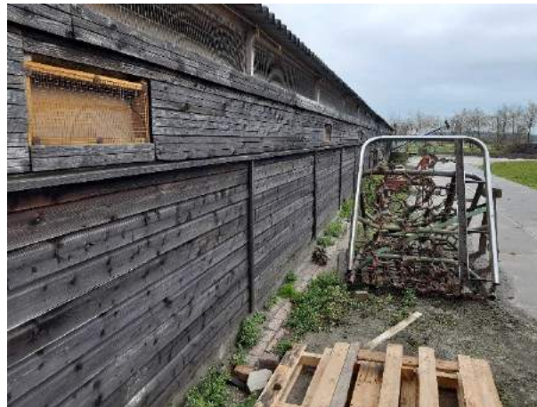
Zuidzijde schuur zonder dakgoot
