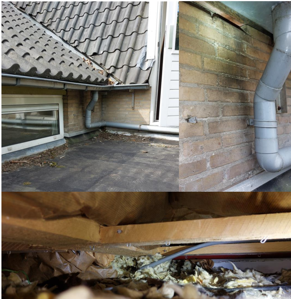
Figuur 4.2 Rustplaats steenmarter in Tellegenschool. Linksboven: Regenpijp op platdak van de school waarachter zich een opening vindt net onder het dak bij een open baksteen (rechtsboven). Onder: Rustplaats van de steenmarter in kapotgemaakt isolatiemateriaal. Bron foto's: Ecogroen.
