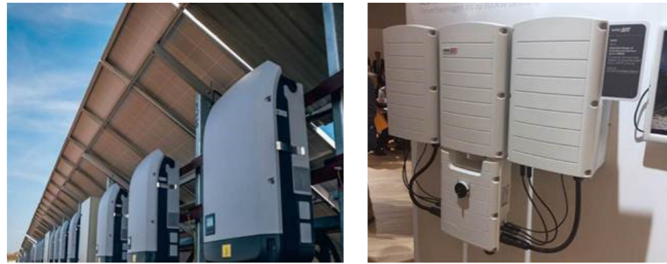
Afbeelding 14. Referentie omvormers onder de zonnepanelen toepassen
