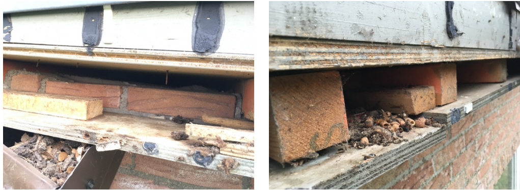
Figuur 11 & 12. Geopende dakrand met achterin de geveltop met spouwopening (I). Rechts een muizenest op de liggende plaat van de dakrand.
